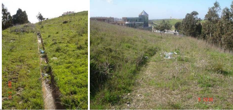
Figures 9 et 10 : Caniveau en crête de talus inexistant par endroit
