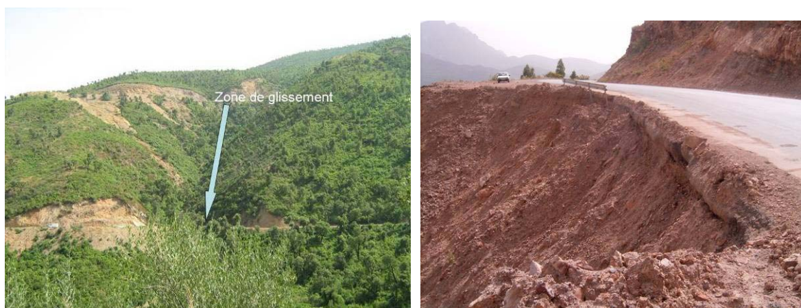
Figures 30 et 31 : vues de la zone de glissement
