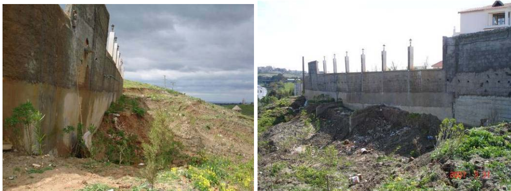
Figure 7 et 8 : Alimentation en eau de la zone glissée à partir du lotissement
