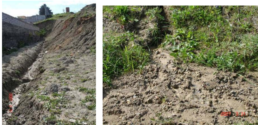
Figures 5 et 6 : Alimentation en eau de la zone glissée par ruissellement à partir des eaux stagnées en amont
