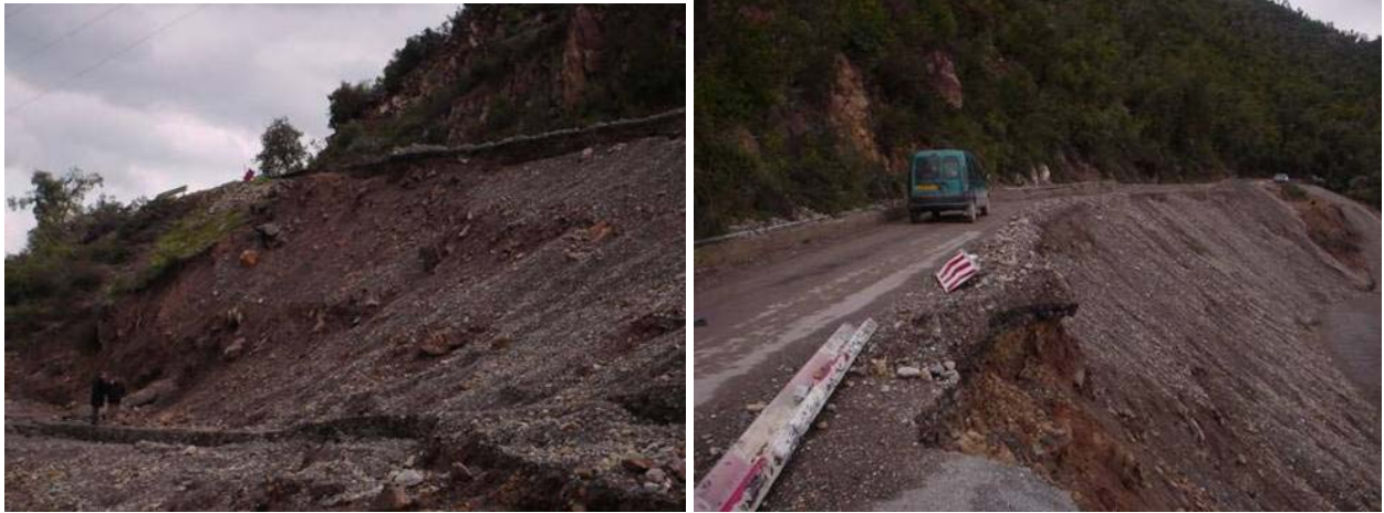
Figures 24 et 25 : vue du glissement
