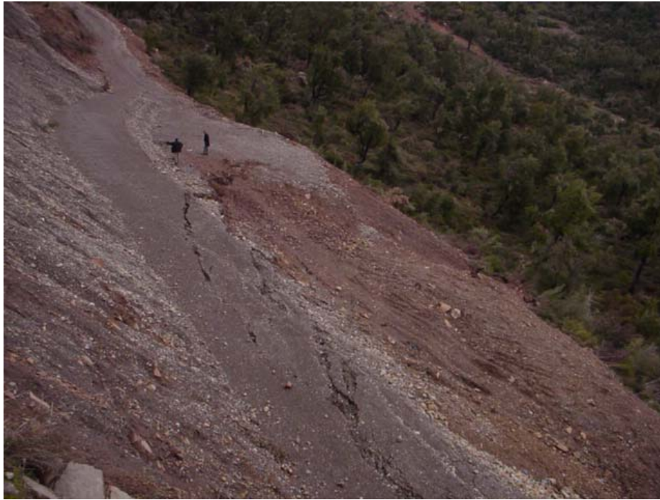
Figure 3 : fissures longitudinales apparues lors de la surcharge par le nouveau remblai
