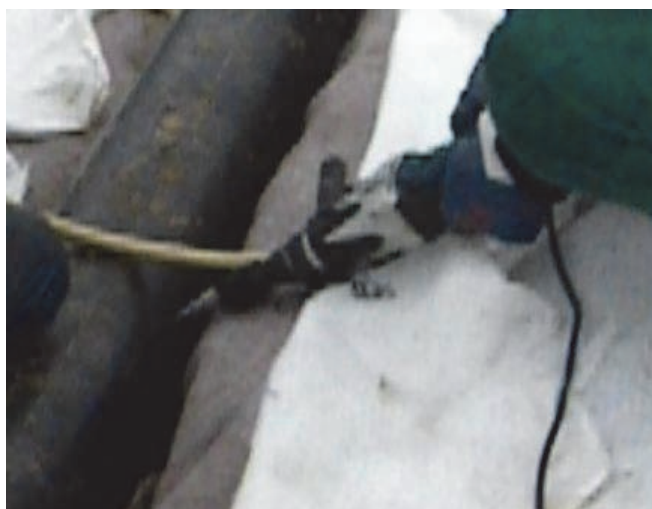
Figure 7. Perforation du drain collecteur plein.
